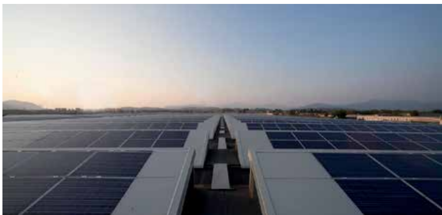
Крыша здания компании, выполненная из фотоэлементов
