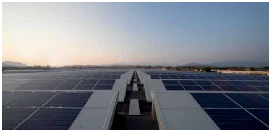
Toiture photovoltaïque de la Société
