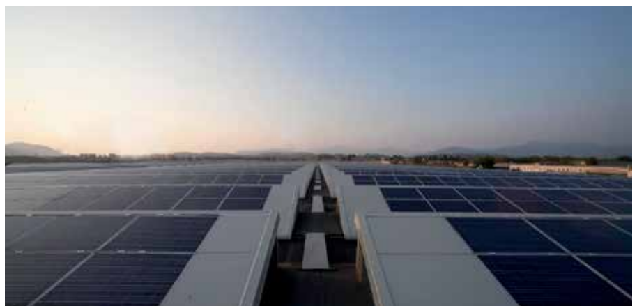
Photovoltaikdach der Firma
